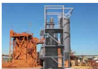
Station de filtration pour traitement des eaux excédentaires
